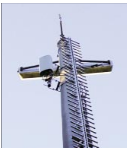
DB0EGT auf dem Kesselberg
